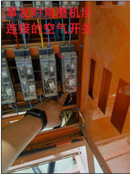
图3 二级配电箱内部情况
