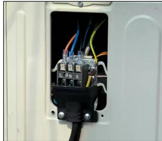
图 4 空调室外机的接线情况
